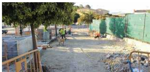
➤ En avenida Manuel de Falla se interviene en el acerado existente en el margen izquierdo colindante con el instituto 'Sierra de Lijar' con sustitución completa de pavimentación y mejora de accesibilidad.
