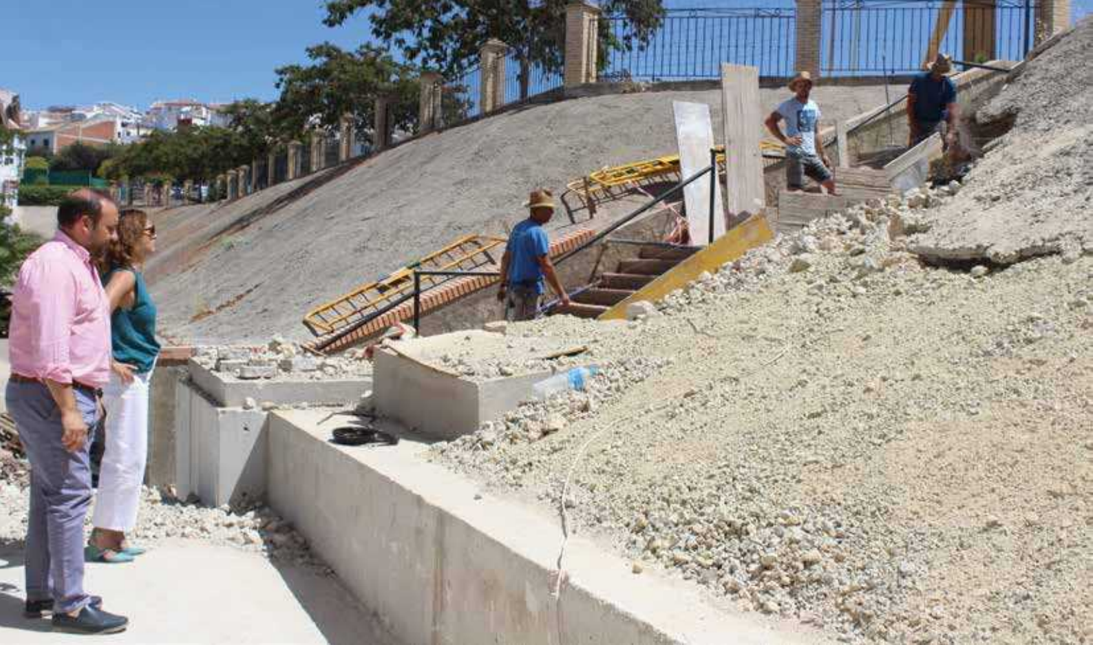
➤ La alcaldesa y el concejal de Urbanismo durante la visita a finales de julio a la obra de emergencia.
