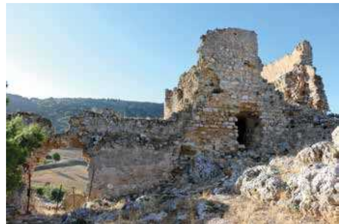
➤ Restos De la Torre del Homenaje y arco de entrada al castillo antes de su derrumbe.
