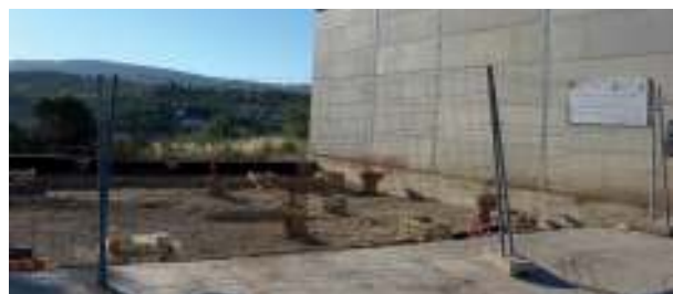
Obras de construcción de nave para vivero de empresas en polígono industrial.
